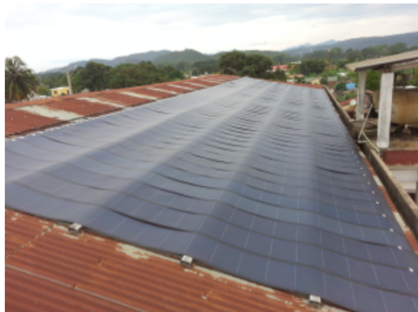
Die Photovoltaikanlage auf dem Dach des CMC
